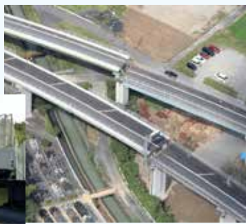
(photo: 国土交通省) 南九州自動車道の損傷した橋梁 (妙見第一橋)
