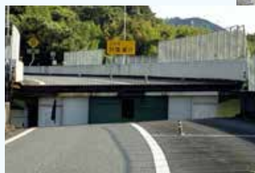
(photo: 国土交通省) 南九州自動車道の損傷した橋梁 (八代JCT - 八代南IC間)
