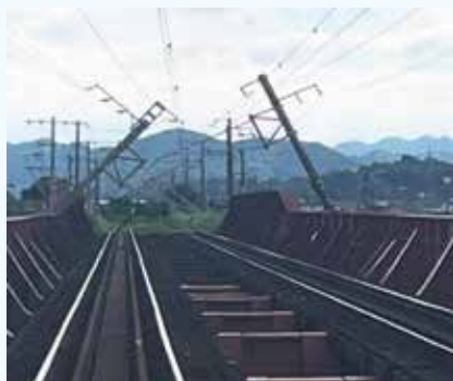
小川駅 - 有佐駅の電柱損傷 (photo: 国土交通省)
